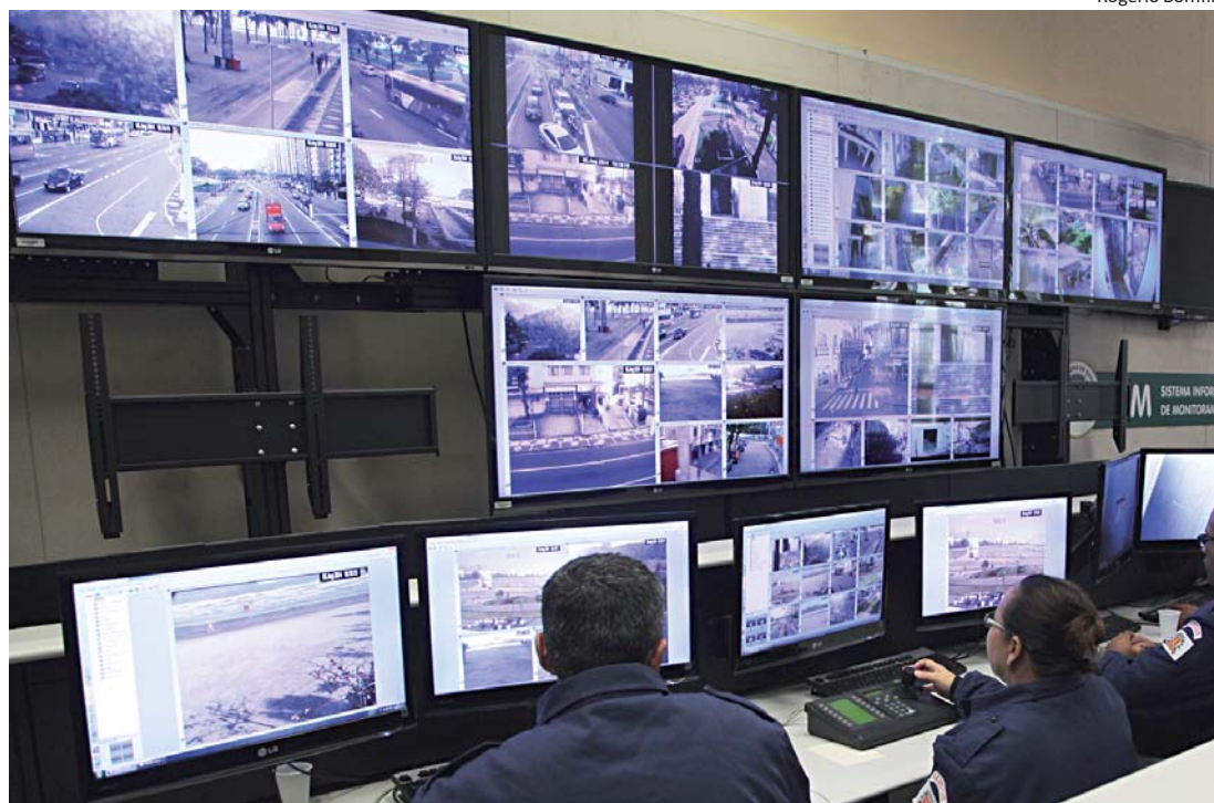
Sistema de videomonitoramento santista será ampliado em capacidade e em formas de integração
